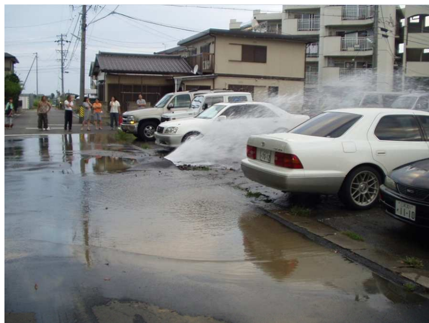
中島町地内 配水管漏水事故 (H19年度)
