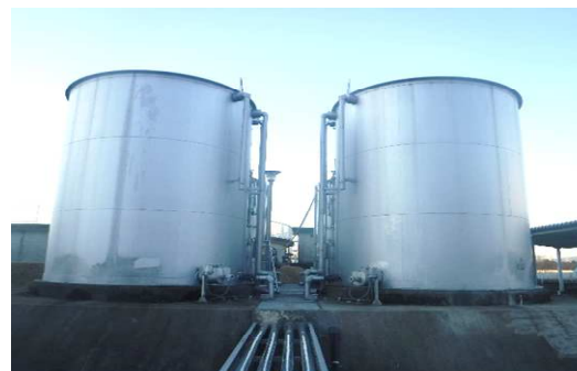
仁木浄水場薬品貯蔵槽
