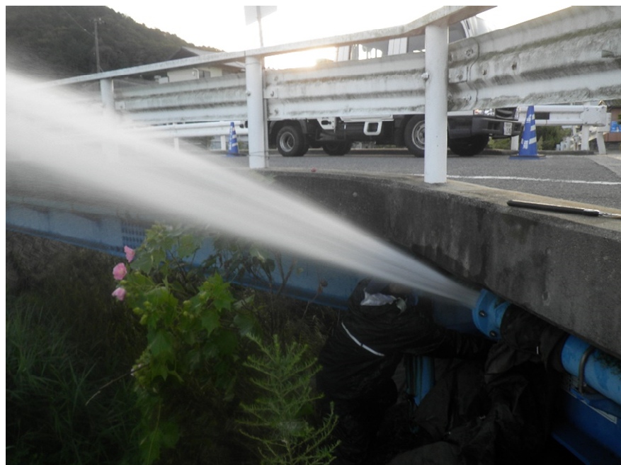
藤川町地内 水管橋漏水事故 (H28年度)
