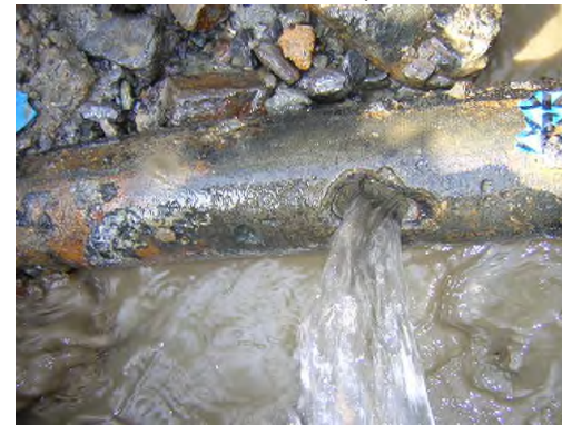
最近の修繕工事事例 市内 φ100mm 鋼管に空いた穴（令和3年）
