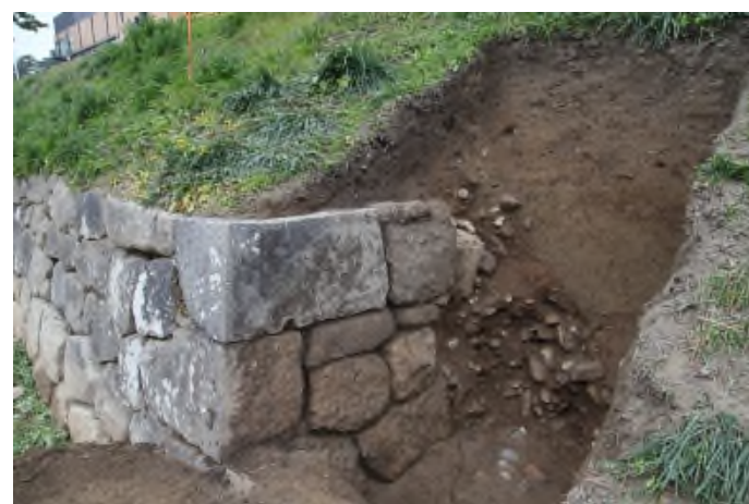
写真7 No. 石垣(隅部の折れ) 一部崩落により裏込め石が流出
