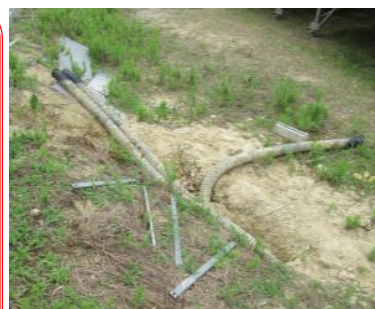
▲被害状況の例
