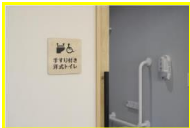
【手すり付き洋式トイレ①】
