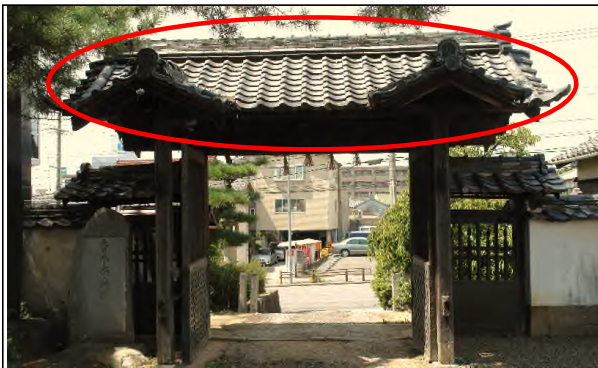
善立寺 山門 修理前
