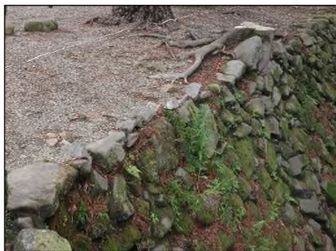
風呂谷門石垣 【施工前】天端上部の不安定な石材
