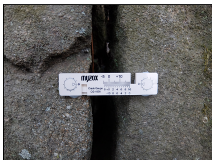
クラックゲージ設置(令和2年1月設置)
