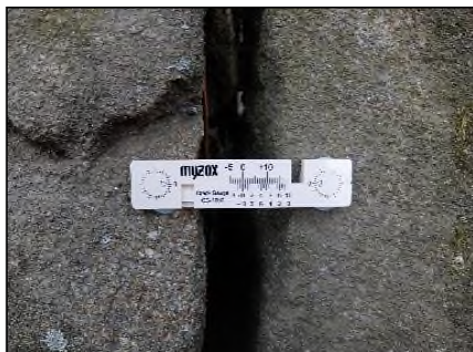
クラックゲージ設置(令和2年1月設置)
