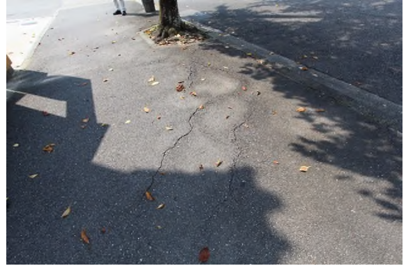
▲街路樹の根上がり（歩道部）
