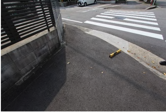
▲交差点部で急こう配の箇所
