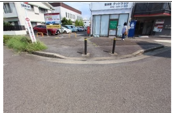
▲交差点部で急こう配の箇所
