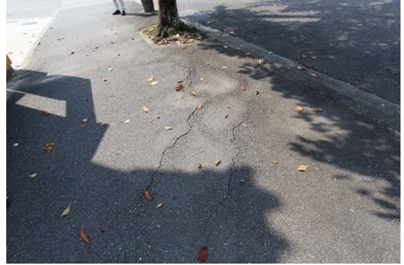
▲街路樹の根上がり（歩道部）
