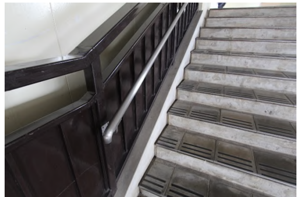
▲2階改札口付近の階段の手すり
