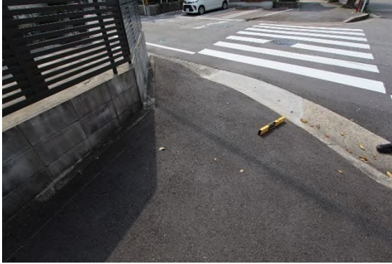
▲交差点部で急こう配の箇所
