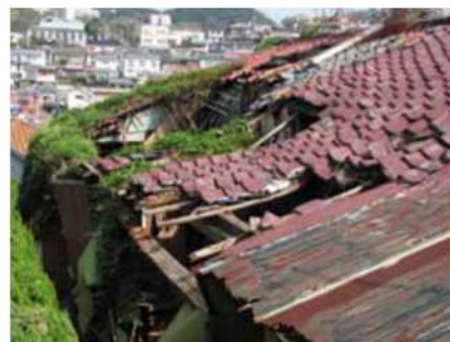
危険空き家の例
