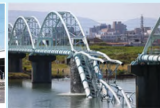
和歌山市水管橋崩落事故 (令和3年10月)
