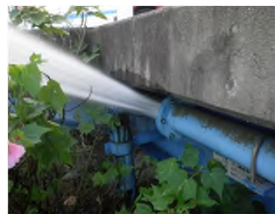
φ150ミリ漏水状況
