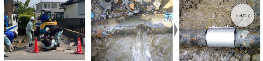
修繕工事の事例：口径100mmの鋼管に空いた穴の緊急修繕（令和3年 市内）
