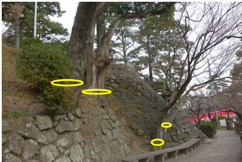
石垣を毀損する樹木の伐採
