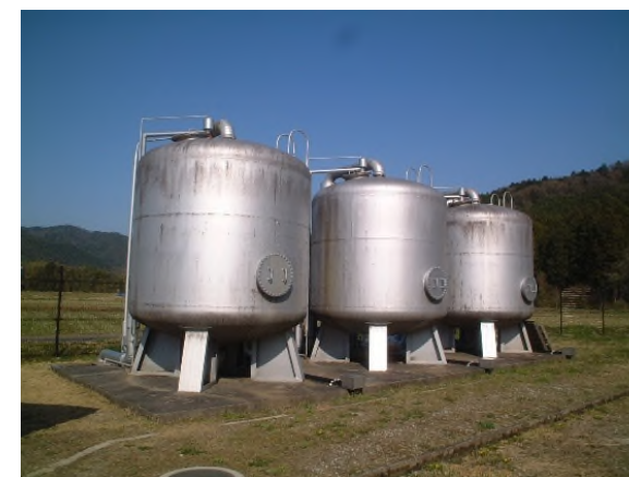
額田南部浄水場水処理設備（急速ろ過機）
