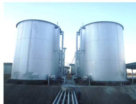
仁木浄水場薬品貯蔵槽
