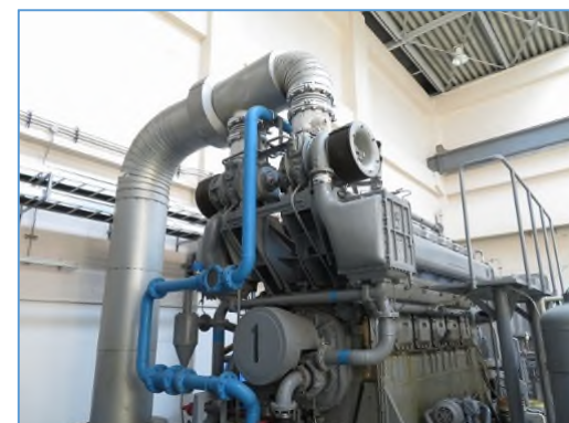
大門雨水ポンプ場 ポンプ用エンジン
