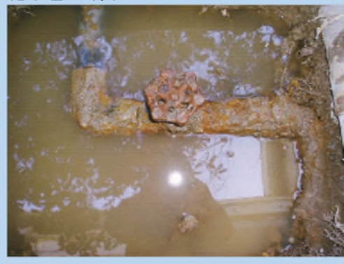
給水管の漏水
