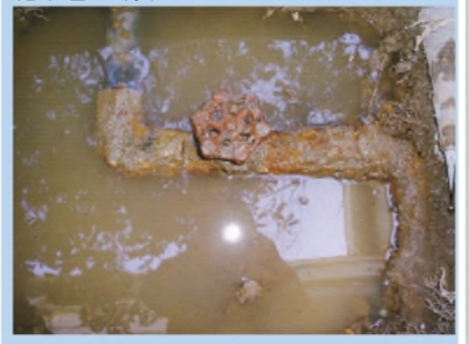
給水管の漏水
