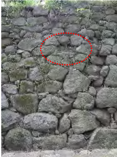
写真 2-31 No.248 石垣の抜け石
