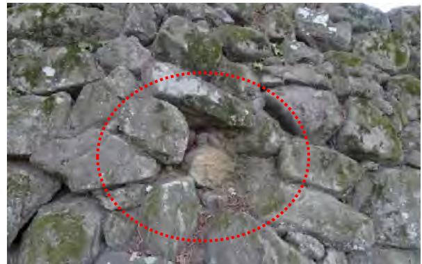
写真 2-19 築石の欠落箇所
