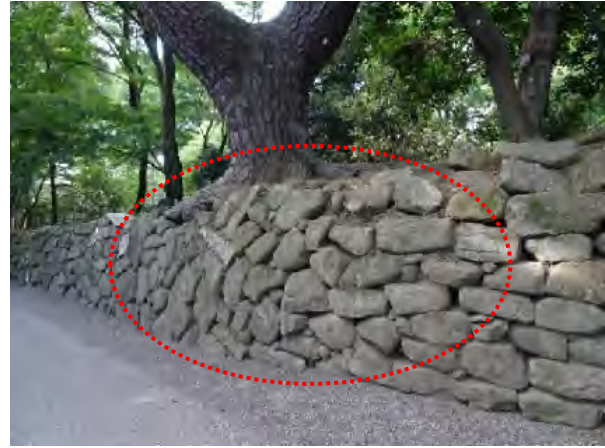
写真 2-24 孕み出し箇所
