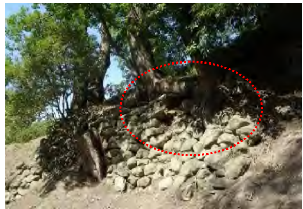
写真 2-28 築石の欠落箇所
