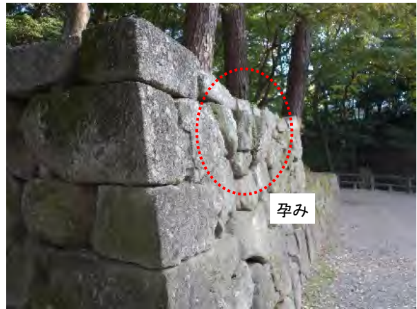
写真 2-22 孕み出し箇所
