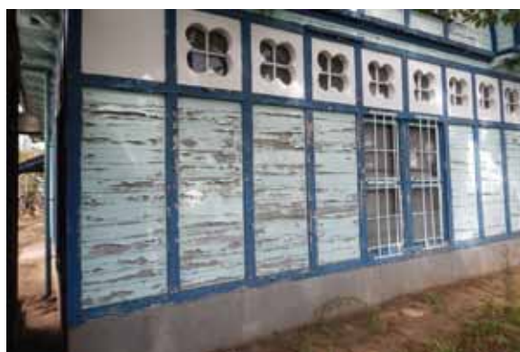
図 2-10 外壁塗装の劣化（東面）
