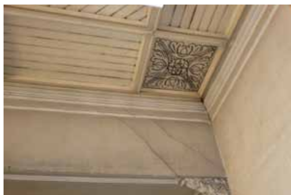
図 2-4 講堂の演壇上の垂れ壁の亀裂
