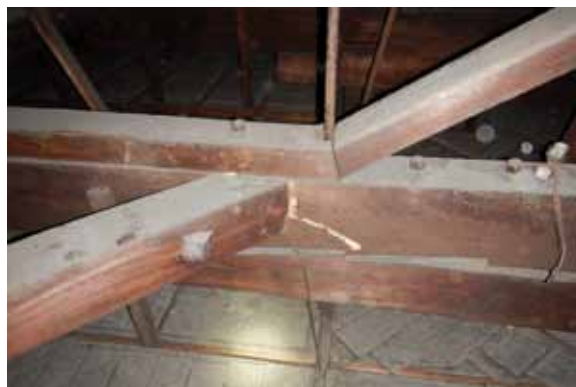
図 2-8 小屋トラス組の折損
