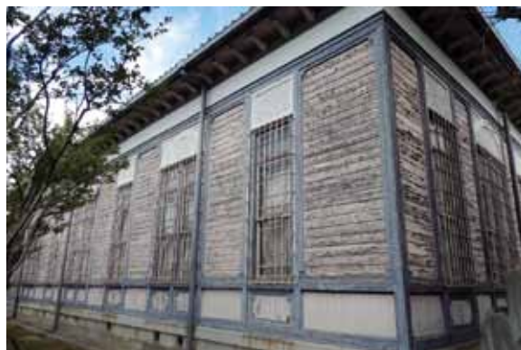
図 2-2 外壁塗装の劣化（会堂棟南東隅）
