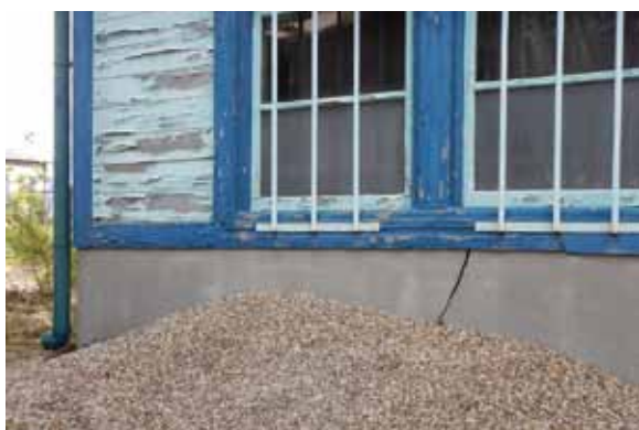
図 2-9 モルタル仕上げの壁の亀裂
