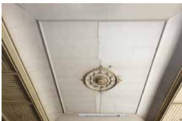
図 2-5 漆喰天井の亀裂（講堂）
