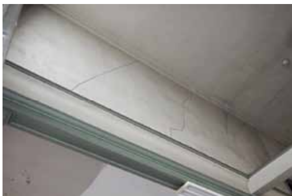
図 2-11 漆喰壁の亀裂
