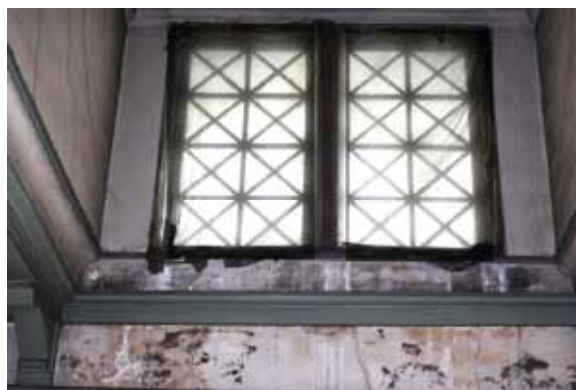
図 2-12 漆喰壁の汚損
