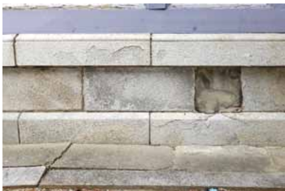
図 2-1 基礎石の剥離、雨落延石の乱れ
