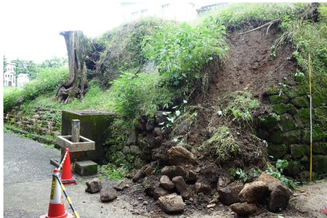
写真7 崩落直後の法面及び石垣
