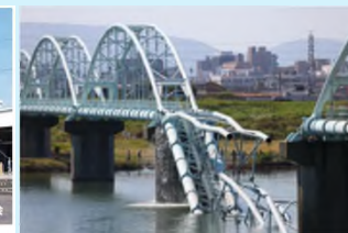
和歌山市水管橋崩落事故 (令和3年10月)
