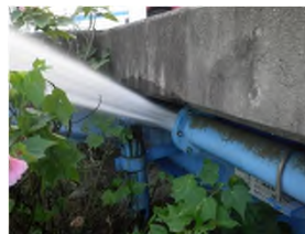
φ150ミリ漏水状況
