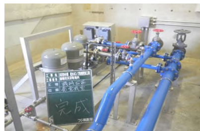
ポンプ設備 (更新後)
