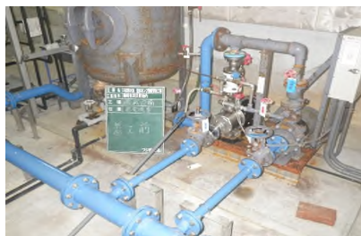
ポンプ設備 (更新前)
