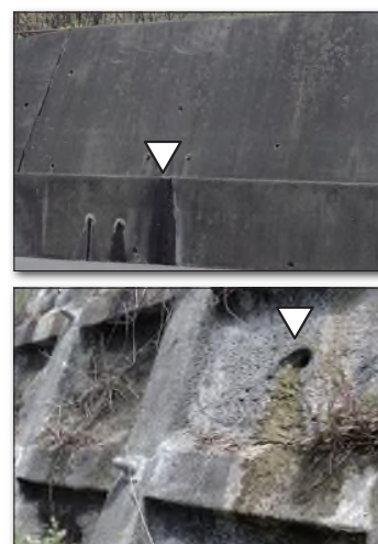
地下水の流出
