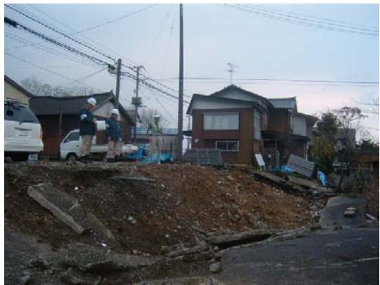
盛土部分が道路とも崩壊した宅地
