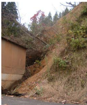
裏山のがけが崩壊した宅地
