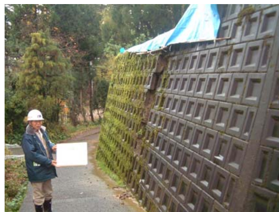
水抜き穴がなく危険な練積み擁壁
