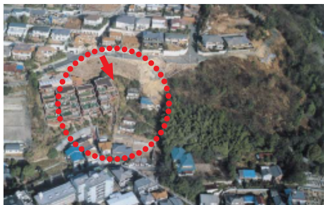
盛土全体が崩れた被害の様子
