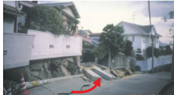
隆起（兵庫県南部地震 最大震度：7）
