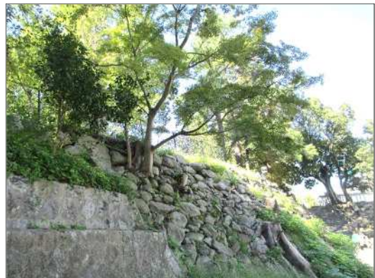
階段袖石垣内の樹木
