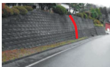
擁壁下端のハラミ出し
