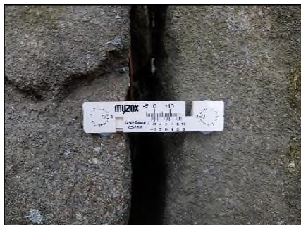
クラックゲージ設置(令和2年1月設置)
