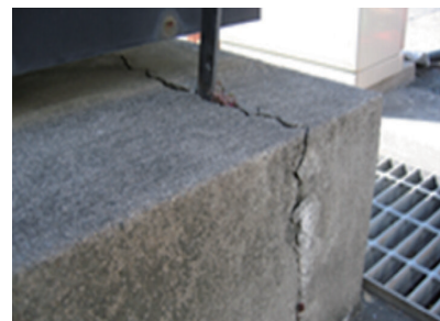
看板基礎のひび割れ
