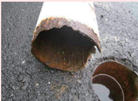
ポールの根腐れによる倒壊
