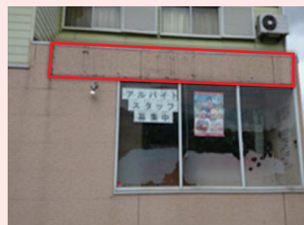
落下した後の壁面
