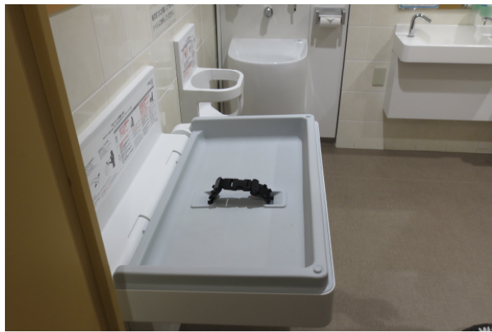
▲ 多目的トイレ内の乳幼児用ベッド
