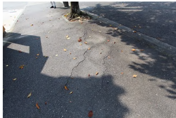
▲歩道部の根上がり
