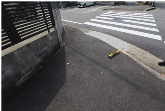
▲交差点部で急こう配の箇所
