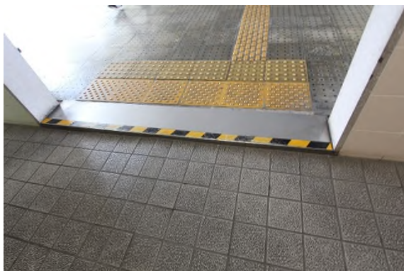
▲トイレ出入口の段差
