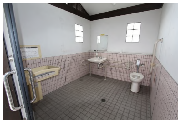
▲多目的トイレ
