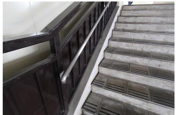
▲2階改札口付近の階段の手すり
