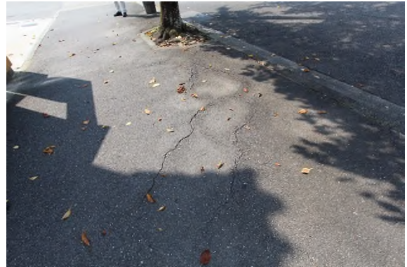
▲街路樹の根上がり（歩道部）
