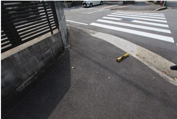
▲交差点部で急こう配の箇所
