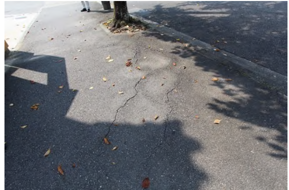
▲街路樹の根上がり（歩道部）
