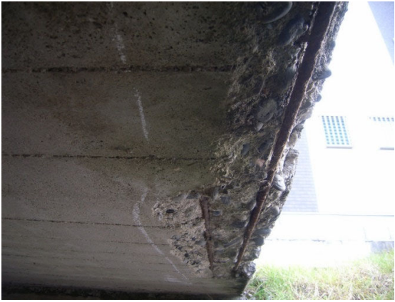
写真2 主桁の剥離・鉄筋露出(Ⅲ判定)
