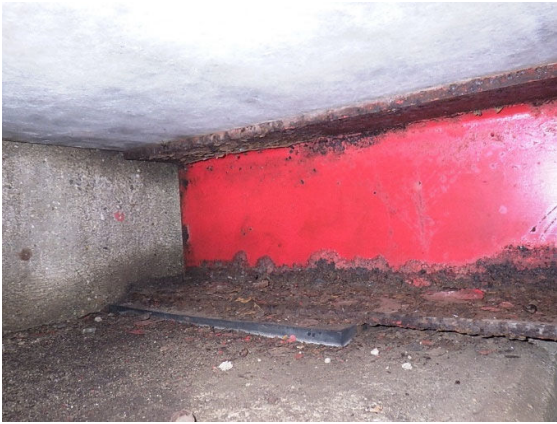
写真1 主桁の腐食(Ⅲ判定)
