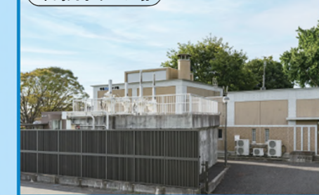
中島雨水ポンプ場
