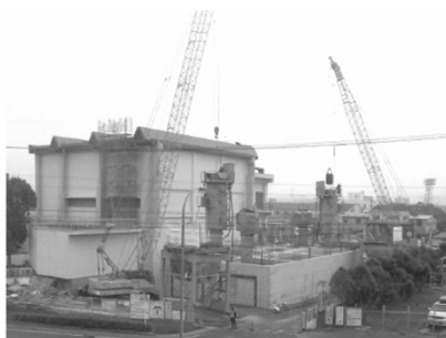
▲大門雨水ポンプ場
