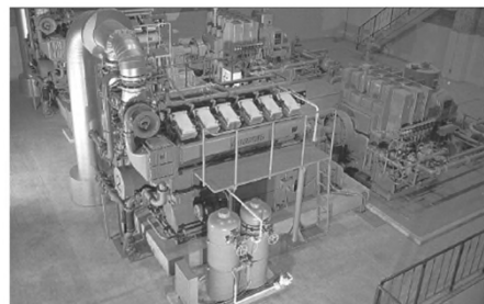
▲ポンプ用エンジン部
