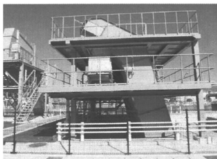
▲スクリーン及び除塵機
