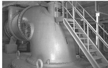
▲ポンプ本体上部
