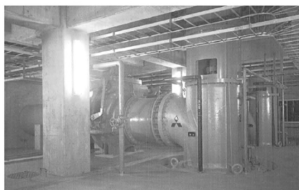
▲ポンプ本体上部
