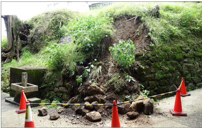
写真2 南切通し西面崩落状況(北東から撮影)
