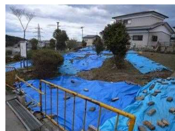
図参2-② 局所的なのり面崩壊
