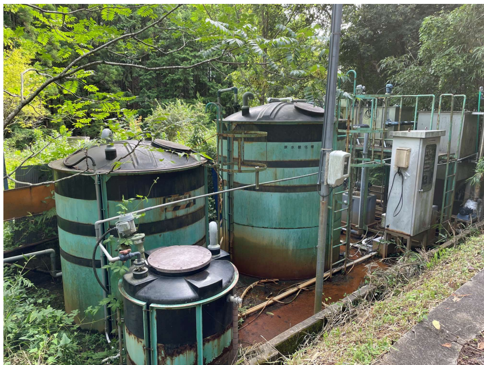
【図表 4－22－18】南大須町の浸出水浄化施設
