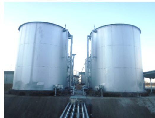
仁木浄水場薬品貯蔵槽
