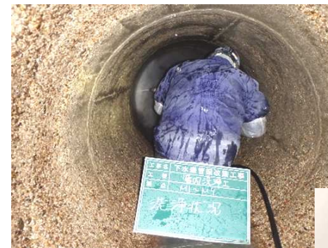
工事前の老朽化した下水道管
