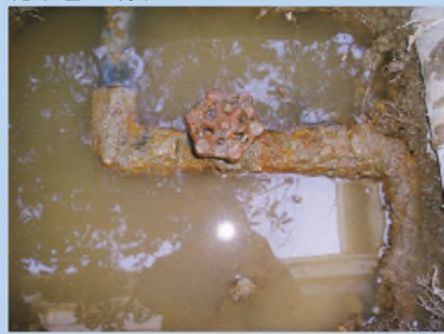
給水管の漏水
