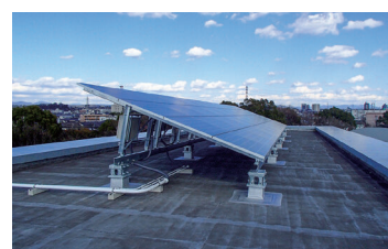
▲太陽光パネル
