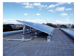
▲ 太陽光パネル
