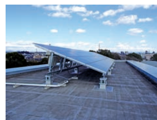
▲ 太陽光パネル
