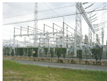
D 中部電力岡崎変電所
