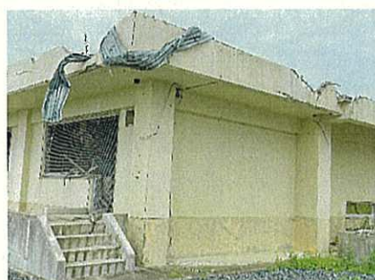
屋根の無くなった体育館
