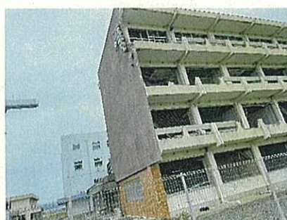
4階まで破壊された校舎
