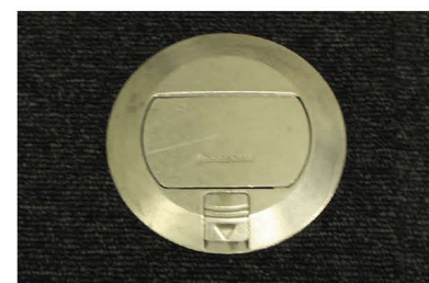
床埋め込みコンセント（閉）
