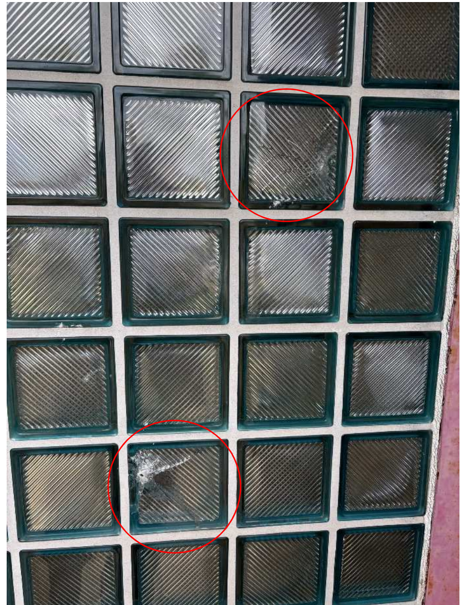
女子トイレ 被害状況②
