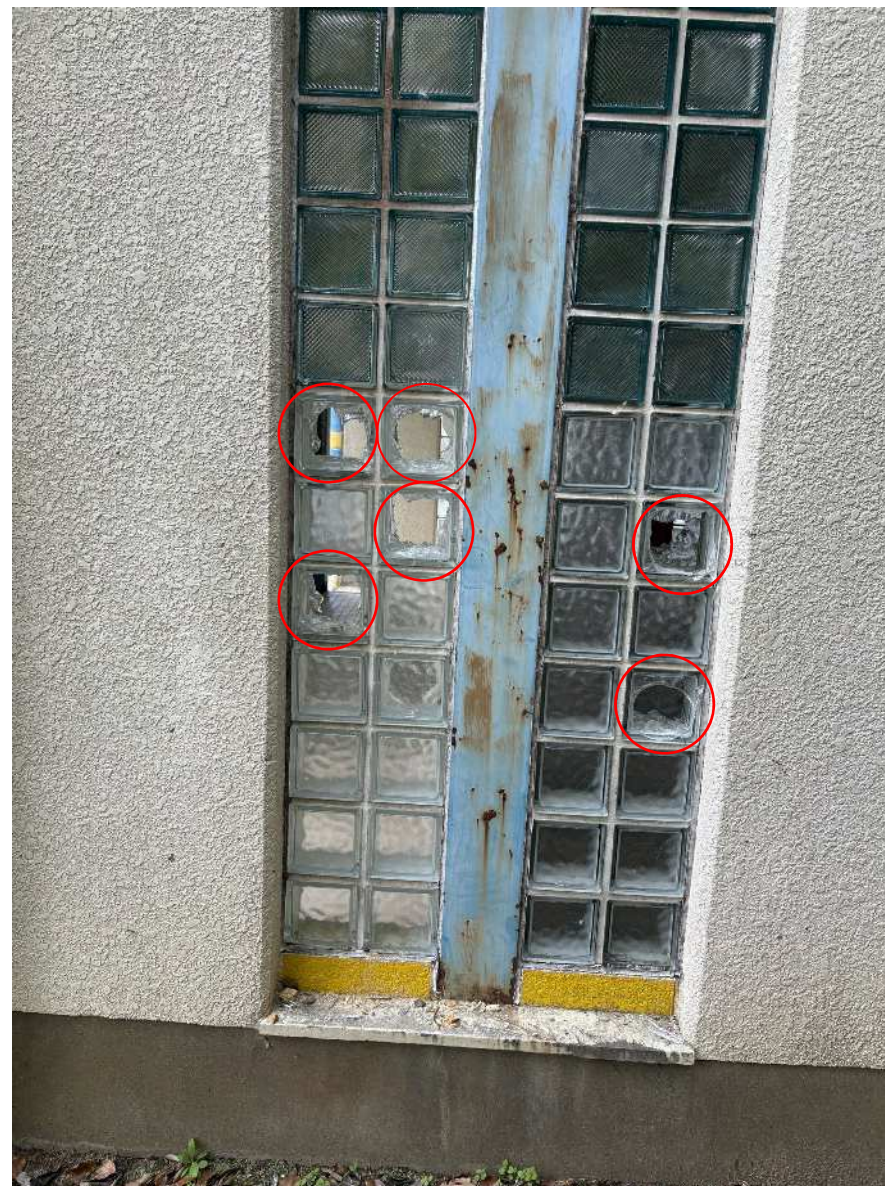
男子トイレ 被害状況②
