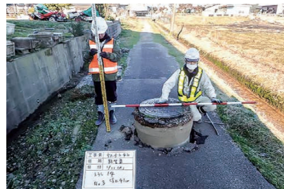
▲地震で浮上したマンホール(令和6年能登半島地震)
