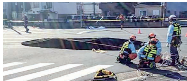
▲下水道管の破損による道路陥没(埼玉県八潮市) 出典:埼玉県ホームページ
